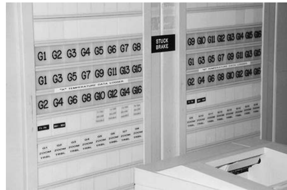
Figura-6 Panel de alarmas luminosas del ZOOM en la sala de control.
