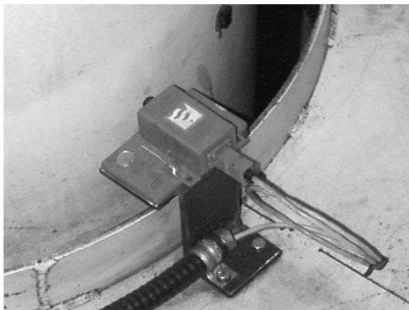
Figura 63: Sonda sencilla de sincronización instalada.
