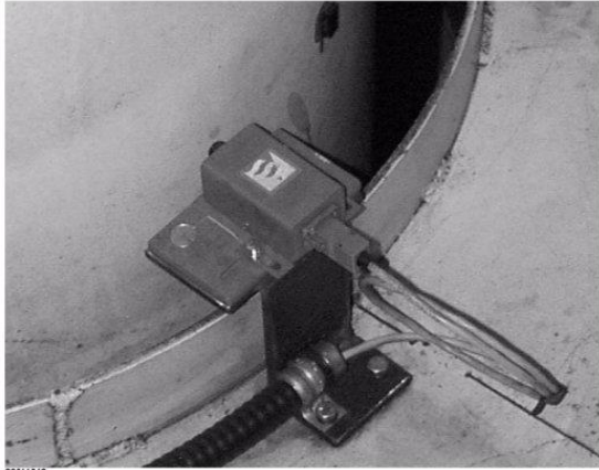
Figura 73: Instalación completa de una sonda de sincronización
