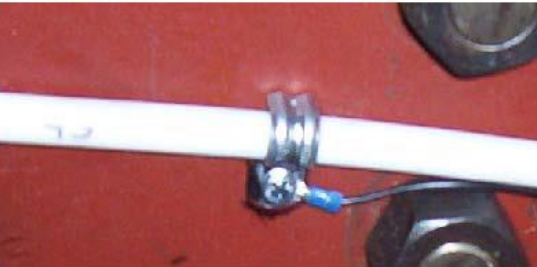
Figura 21: Conexión de un cable de aterrizamiento a la estructura a través de una abrazadera de cable.
