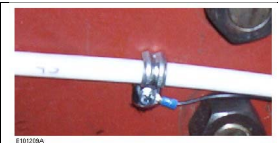
Figura 21: Conexión de un cable de aterrizamiento a la estructura a través de una abrazadera de cable.
