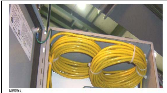
Figura 27: Exceso de cable almacenado en la caja de protección.
