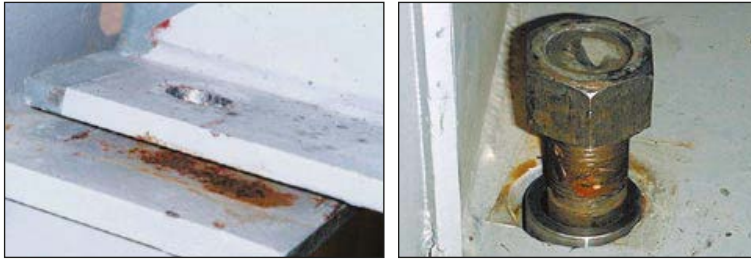
Figure 2 : Vues d'un trou oblong sur le support supérieur du stator (gauche) et de la douille sans aucun jeu du boulon d'ancrage du stator au béton (droite).
